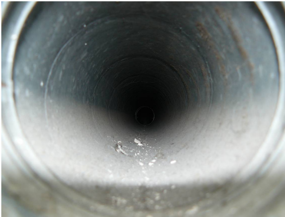
Abbildung 3 - Zuluftrohrsegment Schlafzimmer - Putzreste sichtbar
